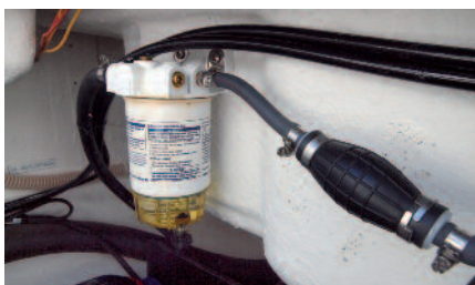
Die technischen Installationen liegen geschützt, aber gut zugänglich unter Deck.
